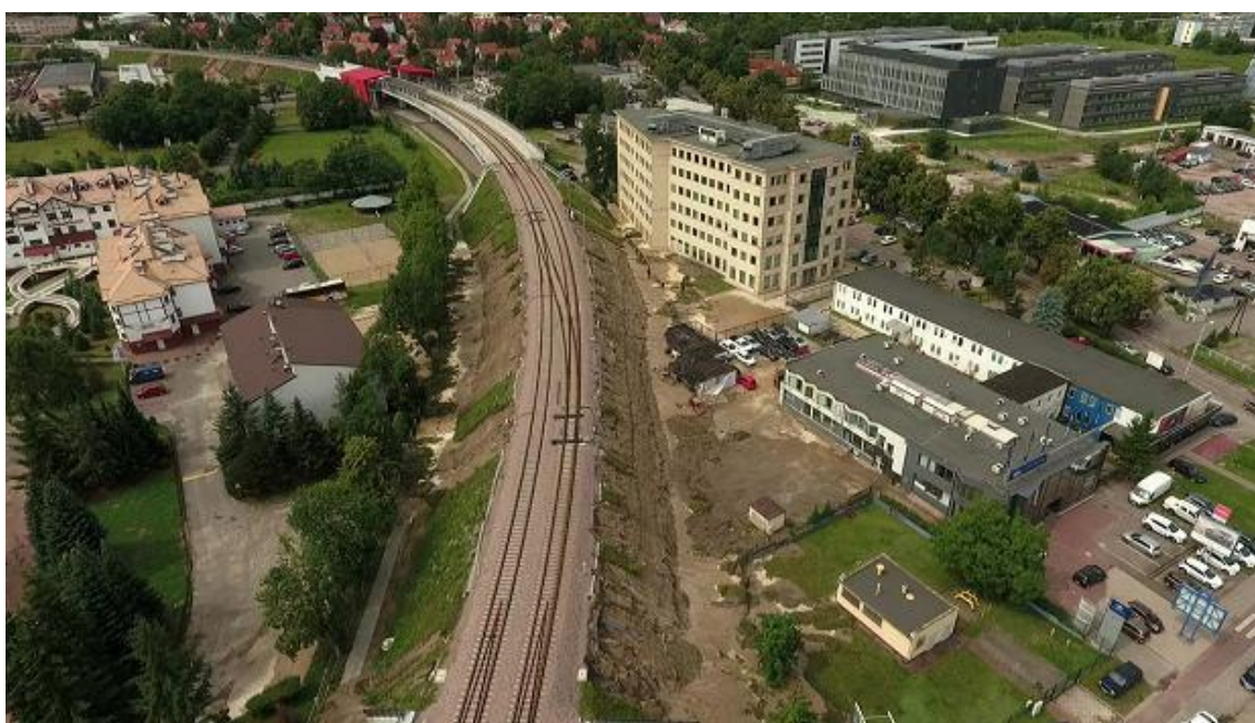
Rys. 9 Skutki ulewy w dniach 14-15 lipca 2016 r. – zniszczony nasyp Pomorskiej Kolei Metropolitalnej, fot. Michał Jamroż, źródło: http://trojmiasto.wyborcza.pl/trojmiasto/5,127406,20402671.html?i=1
