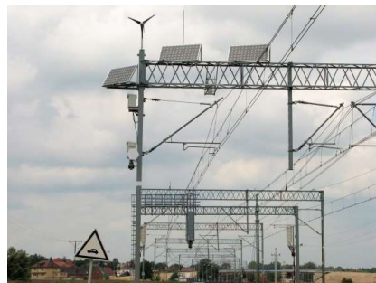
Rys. 2. System monitoringu odbieraków prądu zainstalowany na linii kolejowej 009
